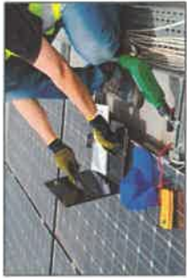
Figure 171 : Illustration de la maintenance des modules photovoltaïques (source : ÉLÉMENTS)
